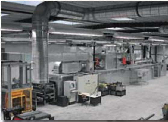
Beschichtungsstraße zum Aufbringen Chrom(VI) freier Zinklamellen-Überzüge
